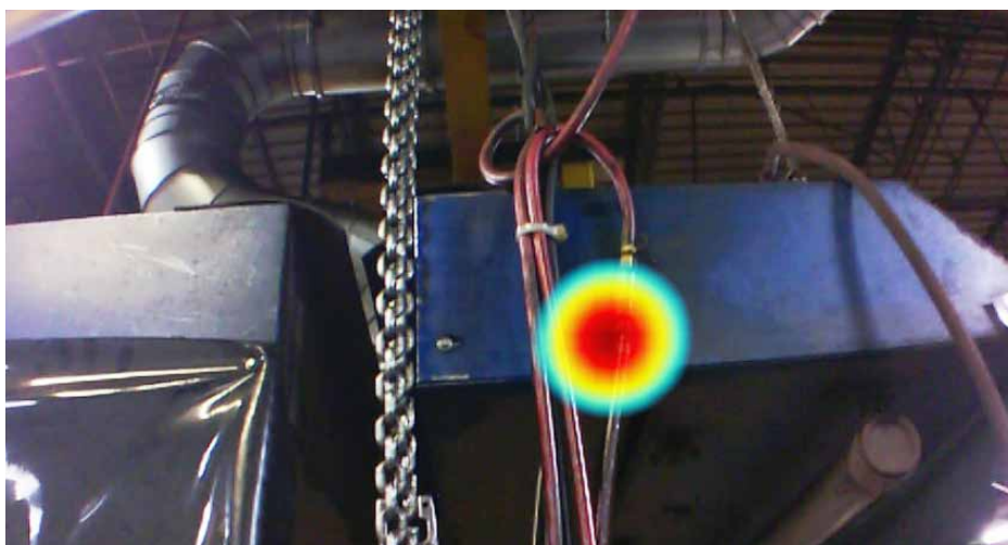
Image prise avec la caméra acoustique industrielle ii900 d'une fuite d'air dans un environnement industriel.
